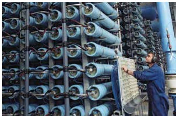
Άποψη του εσωτερικού μιας μονάδας αφαλάτωσης
